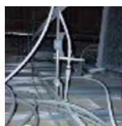
天井裏設置例
