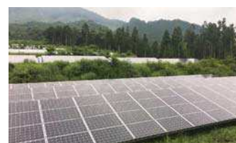
中之条町のメガソーラー発電所
