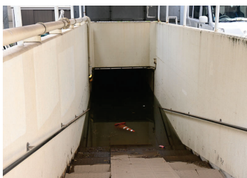
令和6年7月 地下道冠水(岸町)
