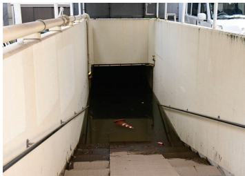
令和6年7月 地下道冠水(岸町)
