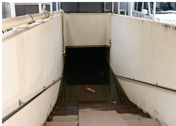
令和6年7月 地下道冠水(岸町)
